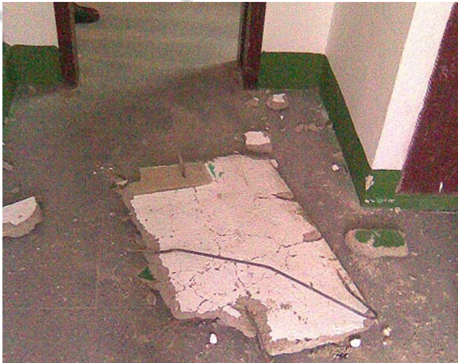
Imagen del interior de una celda en la que un preso derribó la pared a patadas | E.M.
